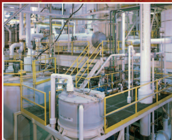
Tratamiento de aguas residuales
